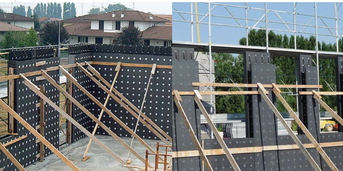
Pannelli accostati messi a piombo tramite puntelli diagonali uniti da una fascia continua inchiodata sui tappi del pannello.
